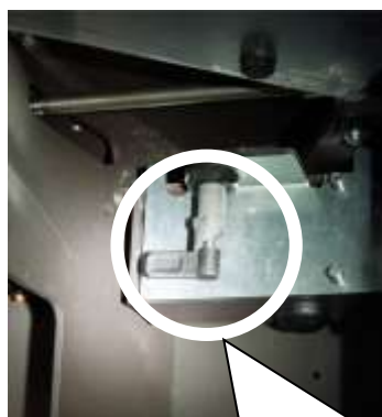
porte en état opérationnel
