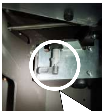
porte en état opérationnel
